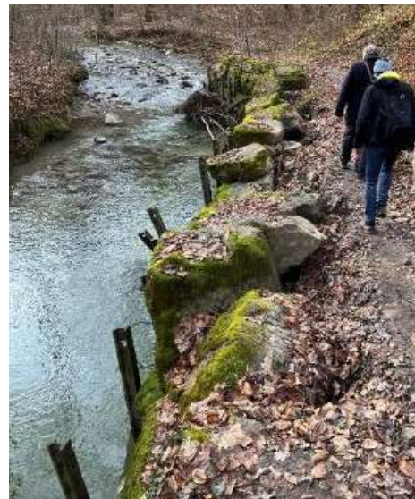
Les enrochements en rive gauche s'effondrent (105 m) du fait de l'incision du lit. Le chemin piéton pourrait être touché par l'érosion à court terme. De plus, les profilés métalliques de soutènement réduisent l'attractivité du paysage.
