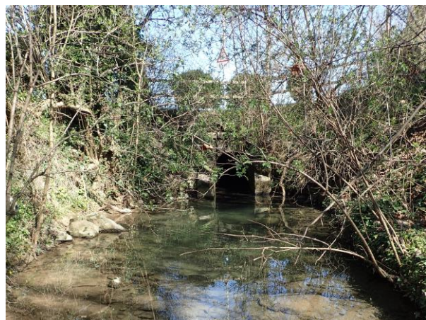
Figure 12 : Blétru à sa sortie de tuyau, au niveau de la route de Morges.
