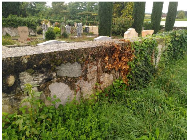
Figure 15 : Mousses et lierre se développant sur le mur du cimetière.
